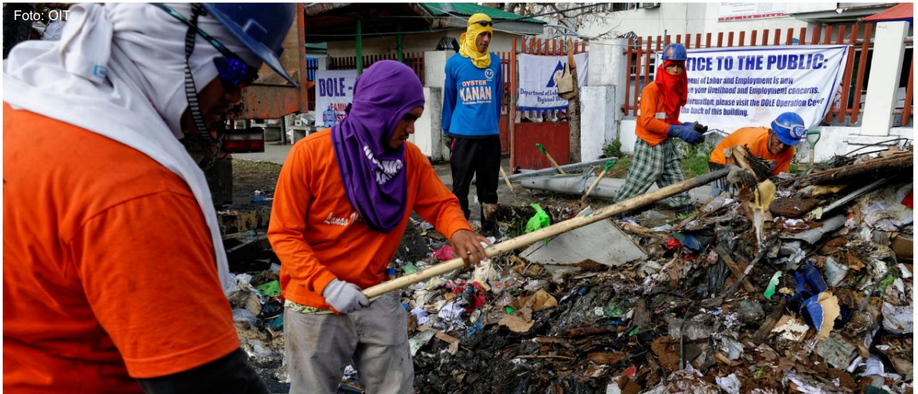
LIMPIEZA: Los trabajadores de recuperación pueden enfrentar un alto riesgo de lesiones o enfermedades al manipular escombros y materiales contaminados con aguas residuales y productos químicos.
